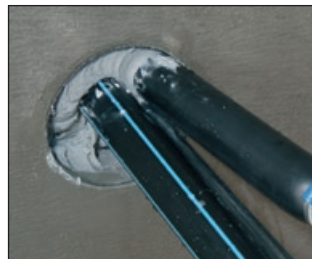
Kein Wassereintritt mehr
